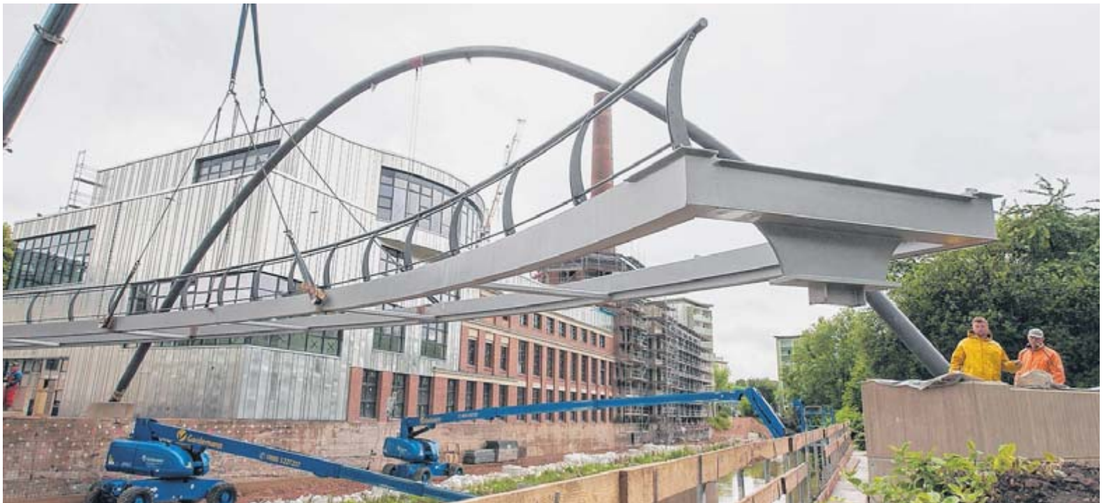
Ein Kran hat gestern neben der Haase-Fabrik die komplette Brücke in ihre Verankerungen zu beiden Seiten des Chemnitz-Flusses gehoben.
